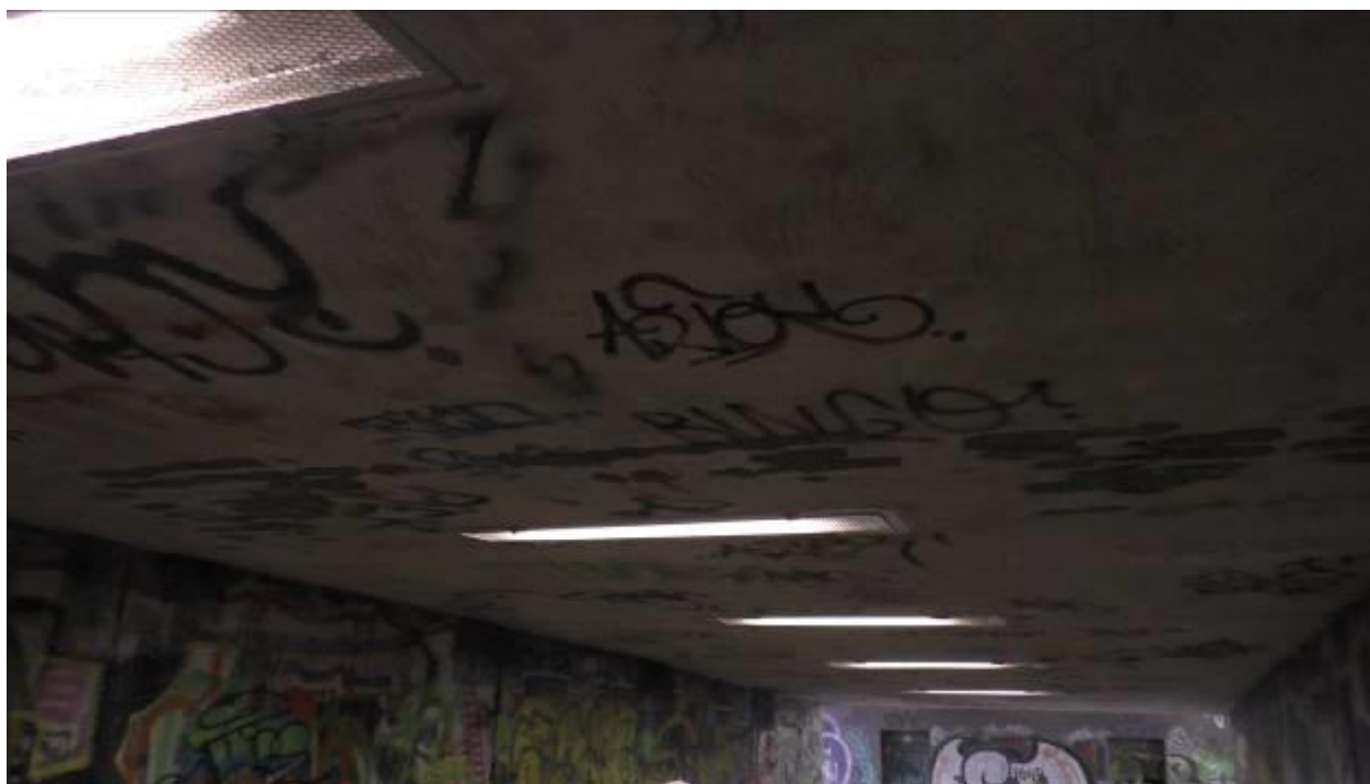
48 pav. Požeminė perėja Laisvės pr. prie Sausio 13 g. Gadinamos ne tik sienos, bet ir požeminėje perėjoje esančios lubos.
