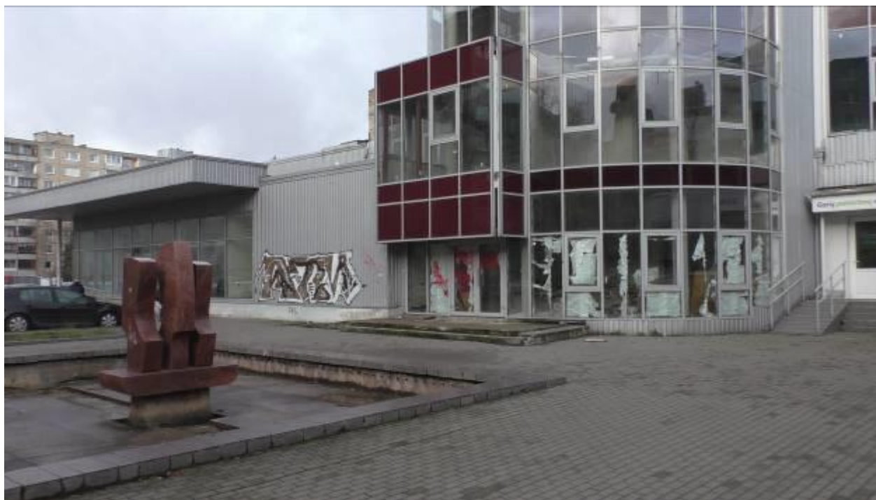
43 pav. A.J. Povilaičio g. prie Laisvės pr.: Apleista pastato dalis. Dalis langų išdaužta, sienos išpaišytos. Prie čia kadaise veikusio fontano dažnai renkasi asocialūs asmenys, ypač šiltuoju paros metu.
